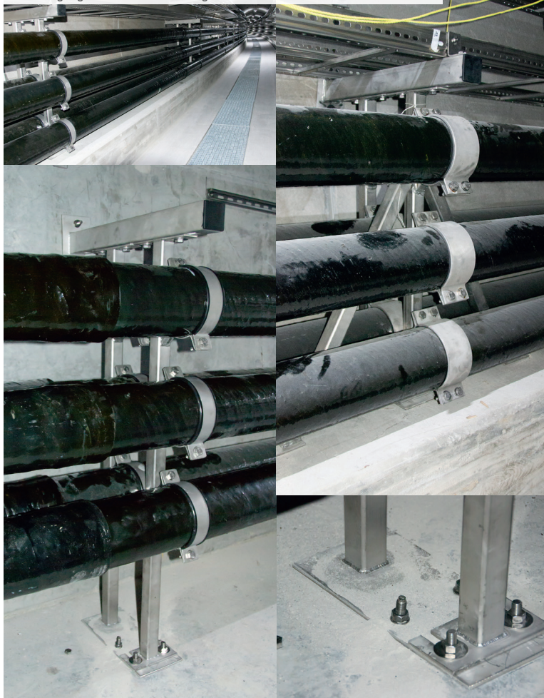
Supportage électrique à haute tension (15kV) pour ligne de train des CFF Befestigung für Starkstromleitungen 15kV für Bahnlinie CFF
