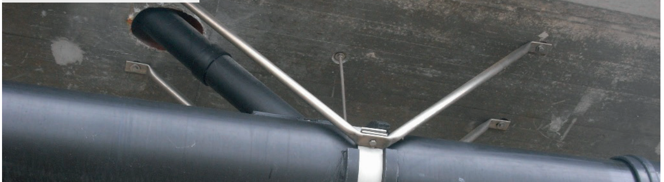
Point fixe arc-bouté sous tunnel d'autoroute. Vertreter Fixpunkt unter Autobahnbrücke.
