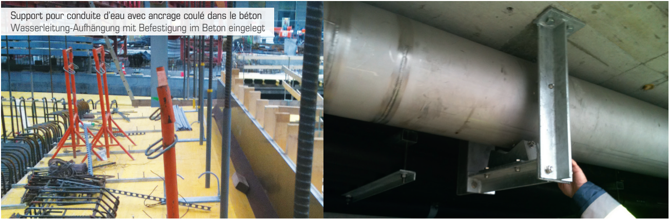
Conduite sur consoles renforcées Leitung auf verstärkten Konsolen
