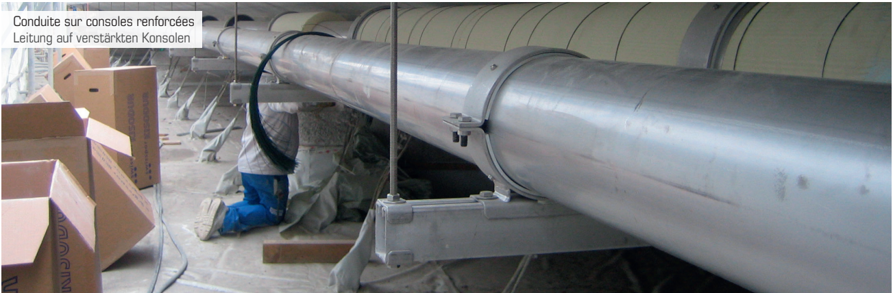
Consoles pour câbles électriques sous un pont d'autoroute Konsolen für Stromleitungen unter einer Autobahn
