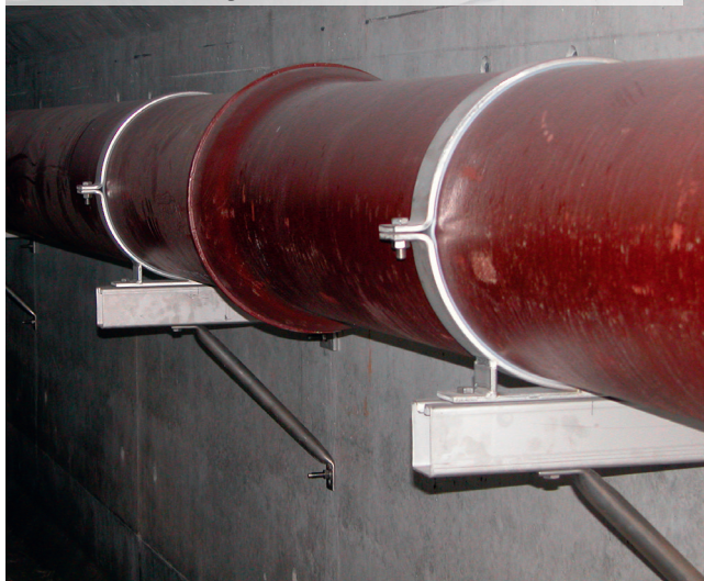
Arc-boutant vertical pour support de conduite dans tunnel d'autoroute Senkrechte Verstrebung einer Konsole in einem Autobahntunnel
