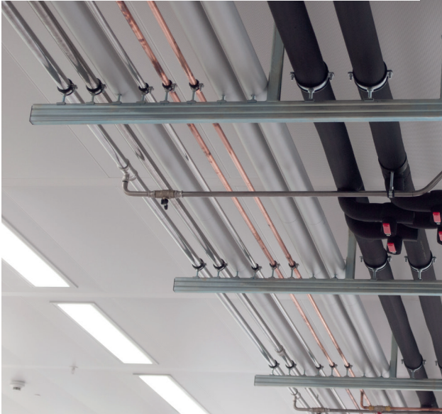
Supportage en commun dans une manufacture Dessous des profils non perforés pour des questions d'esthétique Gemeinsame Befestigung in einer Schmuckfabrik Der untere Teil der Profile ist aus ästhetischen Gründen nicht gelocht
