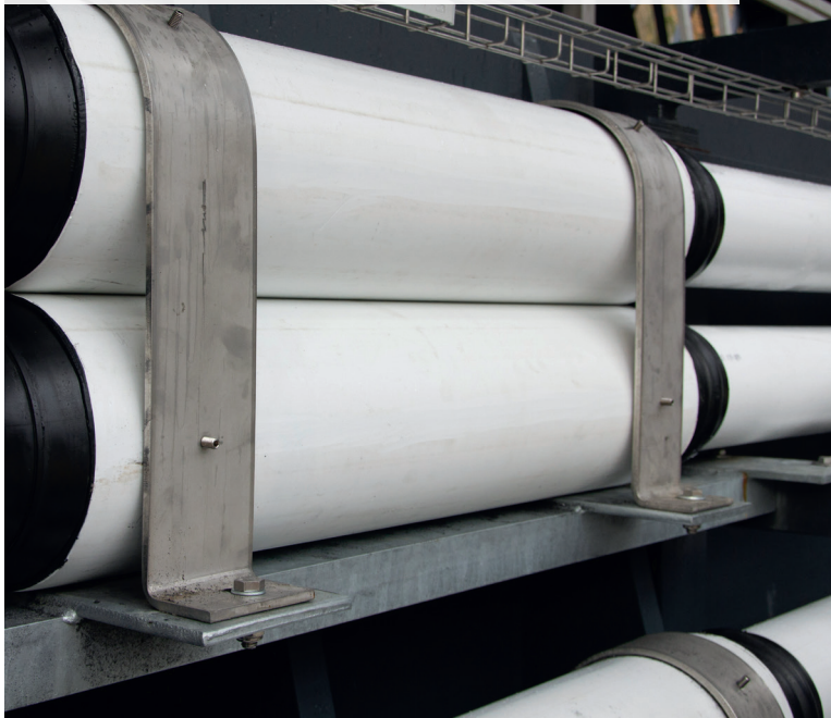
Supportage électrique à très haute tension (130kV) pour ligne de train du CEVA Befestigung für Starkstromleitungen 130kV für Bahnlinie CEVA
